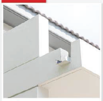
ควบคุมทิศทางน้ำไม่ได้ ทำบ้านเลอะเทอะ
